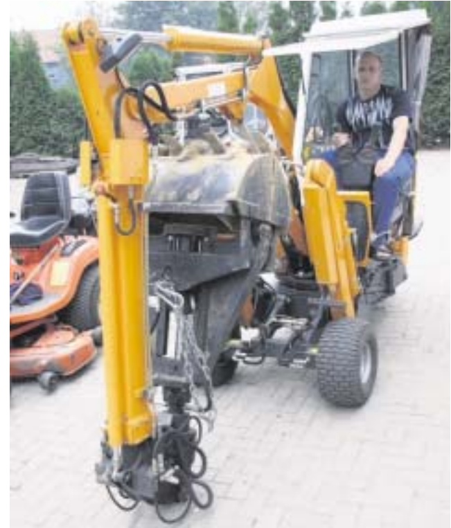
Auf drei Reifen fährt dieser wendige Bagger zum Ausheben von Gräbern - so sinkt er nicht ein. Fotos: WAZ, Sven-Lukas Müller
